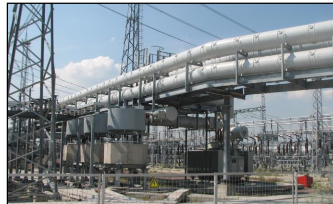
Реконструкции ПС 220 кВ Чесменская
