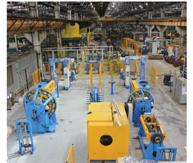
Новое оплеточное оборудование расставлено по местам
